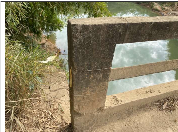
Foto 5: Sujidades aderidas no guarda corpo, e intervenção com arames.. Alex Alves, 30 mai. 2023.
