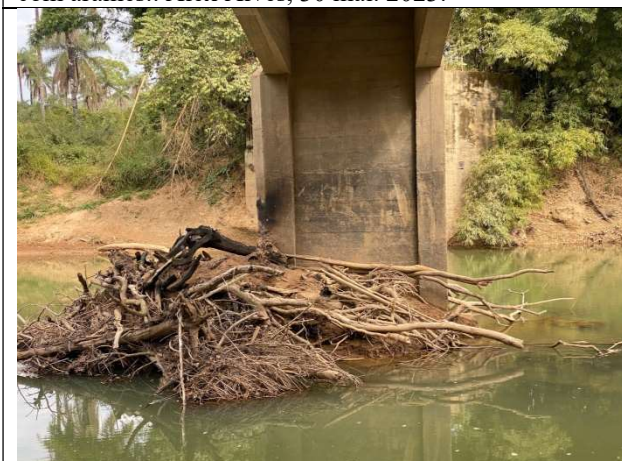
Foto 7: Matéria orgânica presa junto a base do pilar. Alex Alves, 30 mai.
